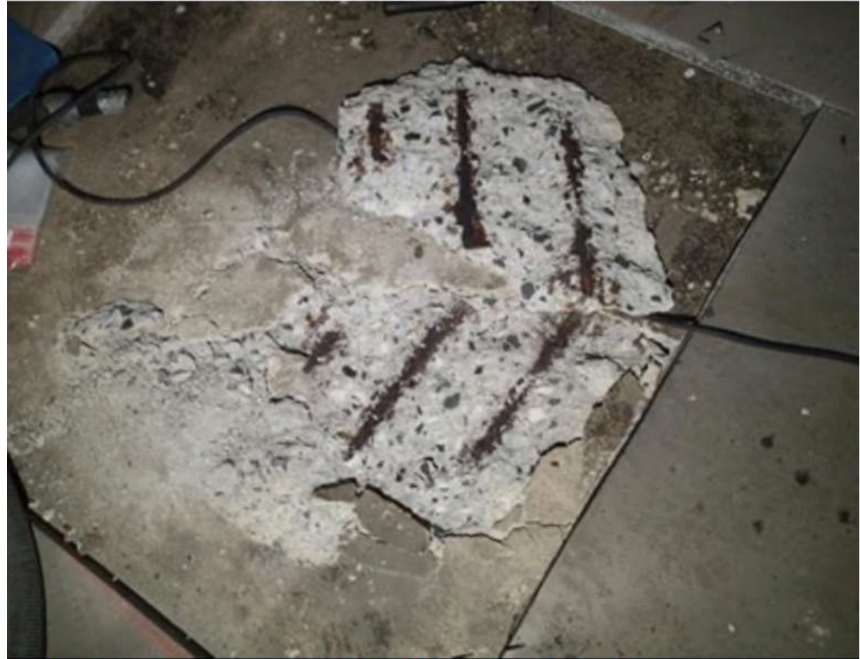
Foto nr. 7: Lett meisling i bomfelt avdekket dette. Det er massiv korrosjon på armeringen. Følgende ble målt i lok. A.:
