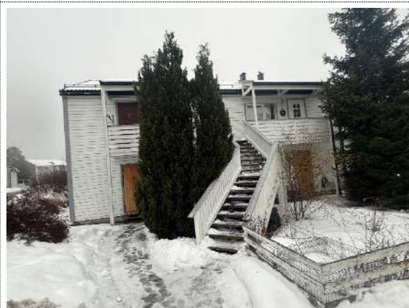
Bilde til tiltak 23.1 Overflatebehandling av kledning og annet trevirke. Skifte ut råteskader, Justere kledning mot terreng.
