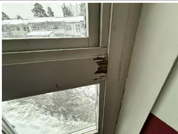
Tiltak 23.2 Vurdere en helhetlig utskiftning av vinduer og balkongdører.
