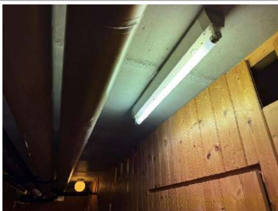
Bilde til tiltak 44.1 Bytte all konvensjonell belysning til moderne LED belysning med moderne lysstyring der det er hensiktsmessig.
