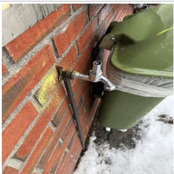
Bilde til tiltak 31.1 Utvendige vannutkastere oppgraderes til frostfrie typer ved behov.
