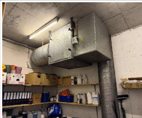
Bilde til tiltak 36.2 Oppgradering av avtrekksvifte i garasje og utstyr.
