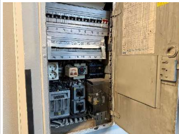
Bilde til tiltak 43.3 Oppgradering av de eldste underfordelingene i løpet av perioden.
