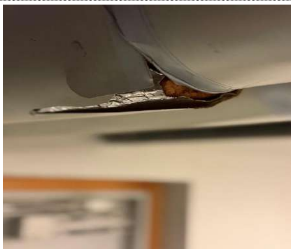
Bilde til tiltak 32.1 Enkelte rørføringer mangler isolasjon eller har behov for reparasjon. Bilde til
