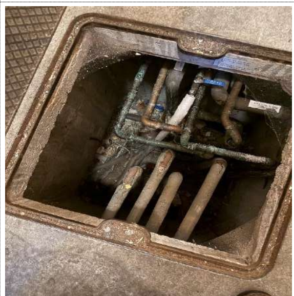
Bilde til tiltak 31.2 isolasjon utbedres, her vist i kum som er Fortums ansvar.
