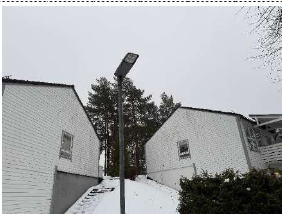
Eksempelbilde: Lyktestolper med tilhørende armaturer utomhus er av type LED. Disse er i tilfredsstillende stand.
