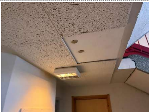
Bilde til tiltak 25.2 Himlinger vedlikeholdes med ny overflatebehandling og nye himlingsplater.
