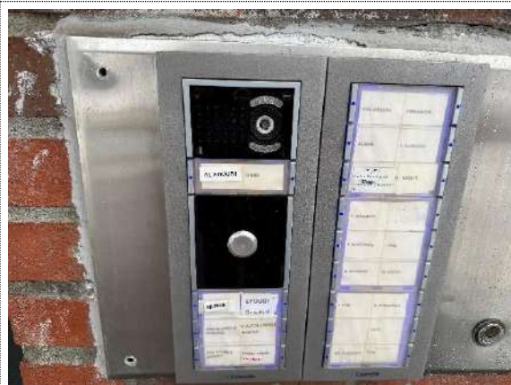
Eksempelbilde: Porttelefonanlegg av nyere dato som er i tilfredsstillende stand.
