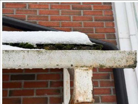
Bilde til tiltak 26.3 Utbedring av utstikkende tak over inngangsparti til blokkene.
